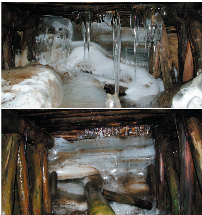
Ryc. 3. Warstwowy lód wypełniający dalszą część sztolni G1b-α na fotografiach z lat 2012 (u góry) i 2015 (na dole), zauważalne cofnięcie czoła lodowego wypełnienia wyrobiska
