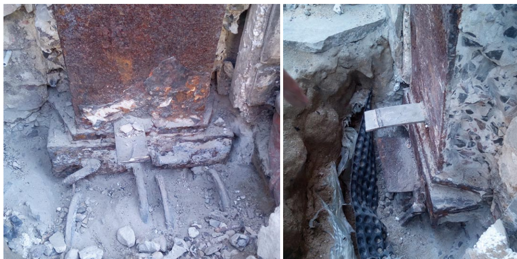
Rys. 10. Korozja pasa zewnętrznego i podstawy słupa stopy ramy w miejscu oparcia na stopie fundamentowej
