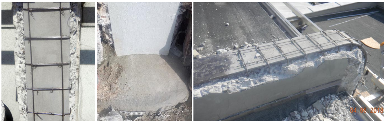
Rys. 11. Widok robót naprawczych zabezpieczenia antykorozyjnego zewnętrznego pasa słupa z zamontowanym zbrojeniem przeciwskurczowym (z lewej), zabezpieczenia stopy ramy (pośrodku) i realizacja zabezpieczenia zaokręglonego węzła ramy i części rygla ponad stropodachem; widoczne zbrojenie nowego obetonowania (z prawej)
