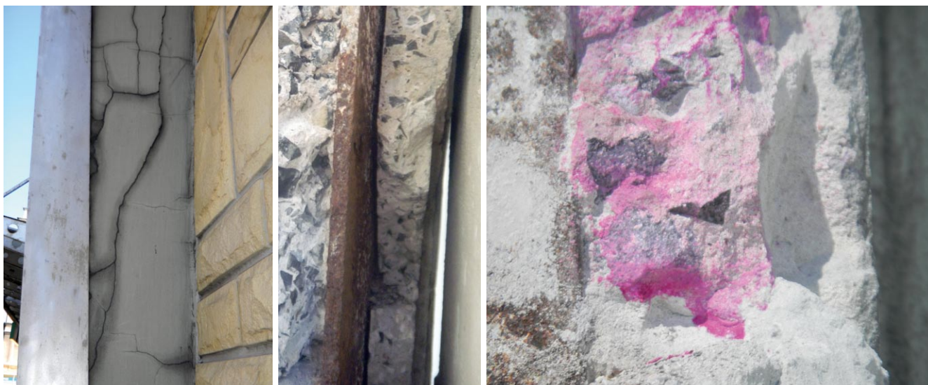
Rys. 6. Spękania obetonowania na pasie zewnętrznym ramy stalowej (z lewej), odkrywka otuliny betonowej i pasa zewnętrznego słupa (fotografia środkowa) oraz odkrywka przekroju otuliny bocznej z widocznymi śladami po badaniach karbonatyzacji (z prawej)
