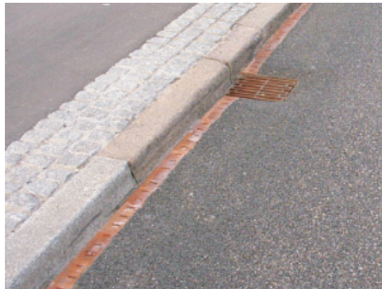
Rys. 4.2. System odwodnienia nawierzchni porowatej w Danii. Wzdłuż krawężnika ułożono kostkę umożliwiającą filtrację odcieków do systemu drenarskiego
