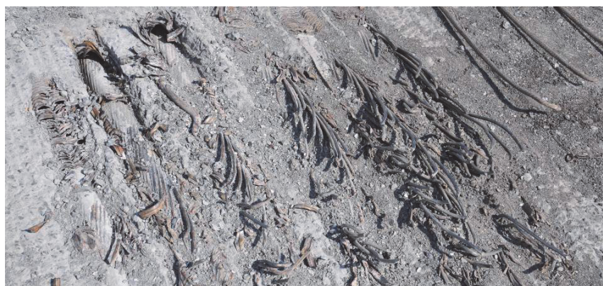
Rys. 3. Uszkodzenia systemu sprężenia: a) typ1, b) typ 2, c) typ 3, opis w tekście
