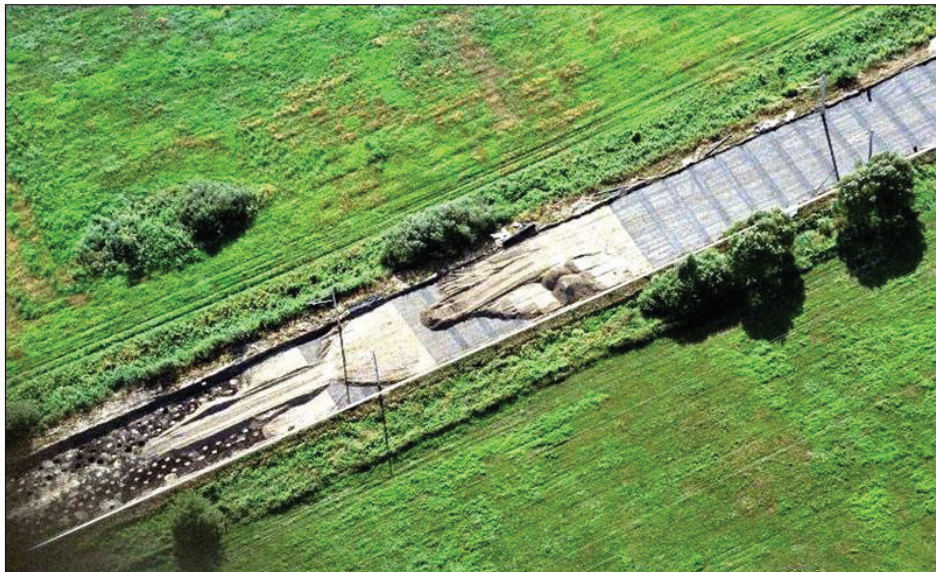
Fot. 7. Typowa sekwencja robót: Linia Kolejowa Berlin-Hamburg, Odcinek: „Paulinenaue” - 3 warstwy zbrojenia nad palami, Fortrac® 200/200-30 M Fot. Huesker Synthetic GmbH
