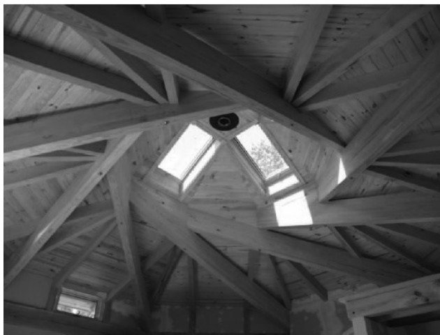
Rys. 3. Układ ramy samonośnej zastosowanej w konstrukcji dachu nie tylko tworzy niepowtarzalny klimat, ale daje również możliwość tworzenia oświetlenia.
