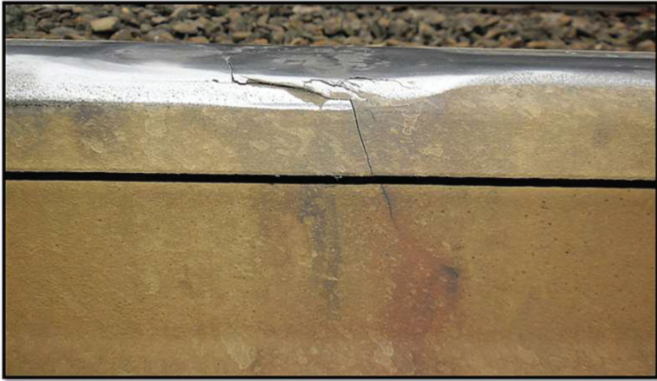
Rys. 4. Pęknięcie szyny UIC 60 rozwijające się od wady podkowiastej Fot. R. Gęsiński
