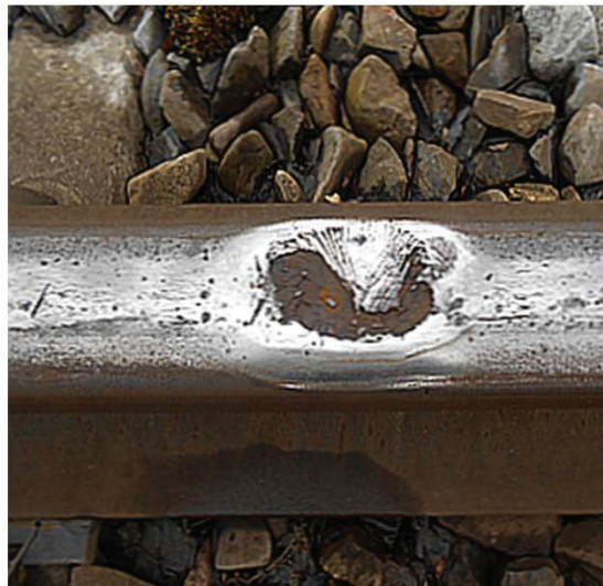
Rys. 3. Wada podkowiasta na szynie UIC 60 obrabianej cieplnie po 25 latach eksploatacji i obciążeniu 84 Tg, podkłady PS83, ruch towarowy, V = 60 \text{ km/h}
