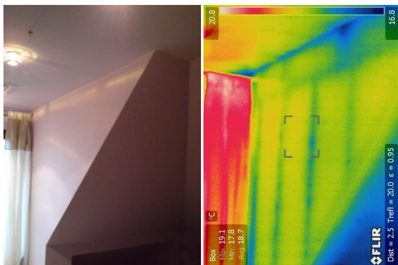
Rys. 13. Sypialnia – termogram nr 12
