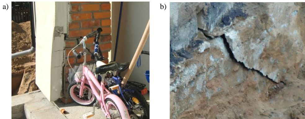
Rys. 4. Przykładowe uszkodzenia obiektu: a) pęknięcie ukośne i poziome filarka przy wejściu, b) pęknięcie ukośne ławy fundamentowej
