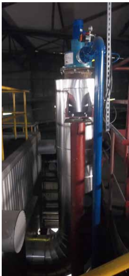
fot2. Urządzenie Pyłofon zainstalowane na obiekcie (zdjęcie dzięki uprzejmości firmy Kwant).
