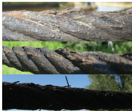
Rys. 8. Wybrane zdjęcia pęknięć drutów warstwy zewnętrznej na linii L19
