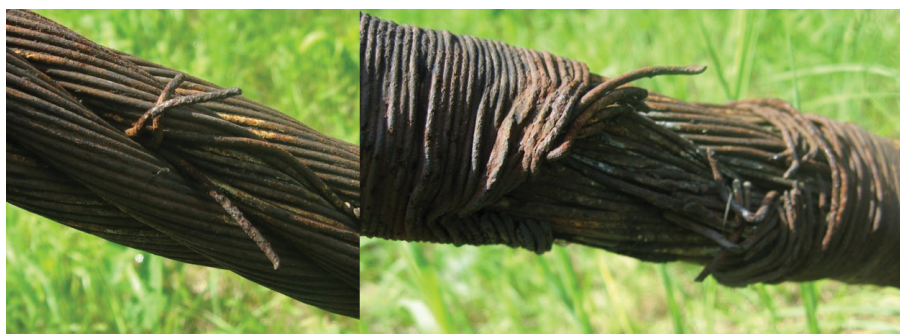
Rys. 7. Uszkodzenia i zaawansowana korozja drutów linii L01
