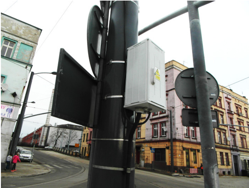
Rys. 7. Widok rejestratora danych przymocowanego do słupa po instalacji
