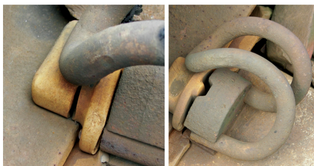
Rys. 8. Uszkodzenia nie eliminujące jeszcze połączenia szyny z podkładem: z lewej pęknięta wkładka, z prawej przesunięta wkładka izolacyjna
