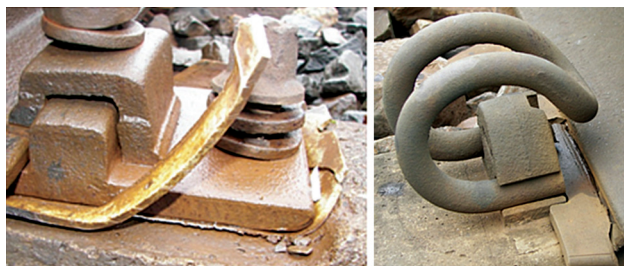
Rys. 7. Uszkodzenia, które należy uwzględnić w obliczeniach: z lewej przekładka o nominalnej grubości 3 mm zgnieciona do grubości 1 mm i rozluźniony pierścień sprężysty; z prawej brak wkładki izolacyjnej i pęknięta przekładka
