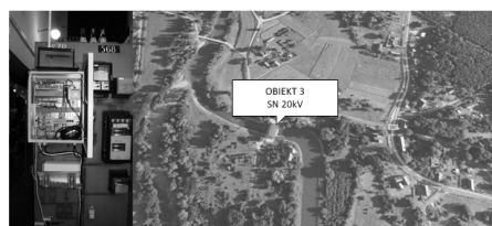
Rys. 2.3. Lokalizacja i realizacja układu pomiarowego parametrów JEE (OBIEKT 3) [3]
