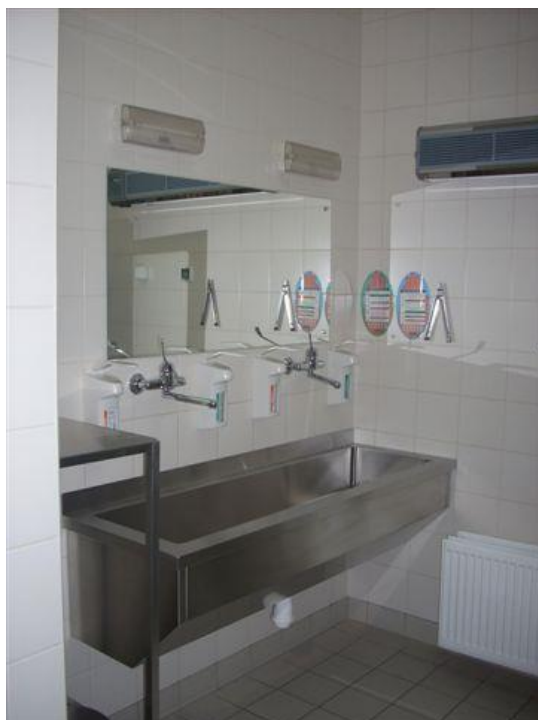
Il.5. Umywalnia sali operacyjnej oddziału chirurgii szpitala Aresztu Śledczego w Krakowie przy ul. Montelupich 7. Realizacja z lat 2004-2005, według projektu zespołu: Andrzej Walkowski, Dariusz Ociepa, Bartłomiej Rados (z materiałów archiwalnych biura projektów Studio AW).
