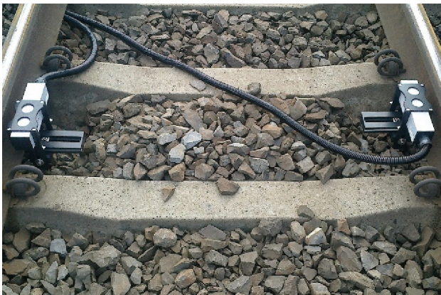
Rys. 4. Anteny pomiarowe zamontowane w torze kolejowym [archiwum Zakładu]
