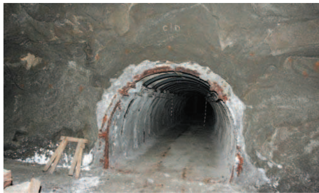
Rys. 2. Wlot do komory Ferdinand d'Este. Widoczna korozja łuków ŁP i wypełnienie obudowy chodnika betonem natryskowym, fot.: A. Maj [11]
