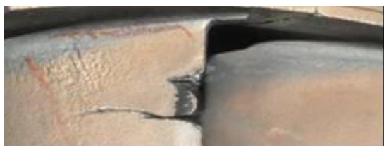
Fot. 3 Pęknięcia krawędzi spływu
