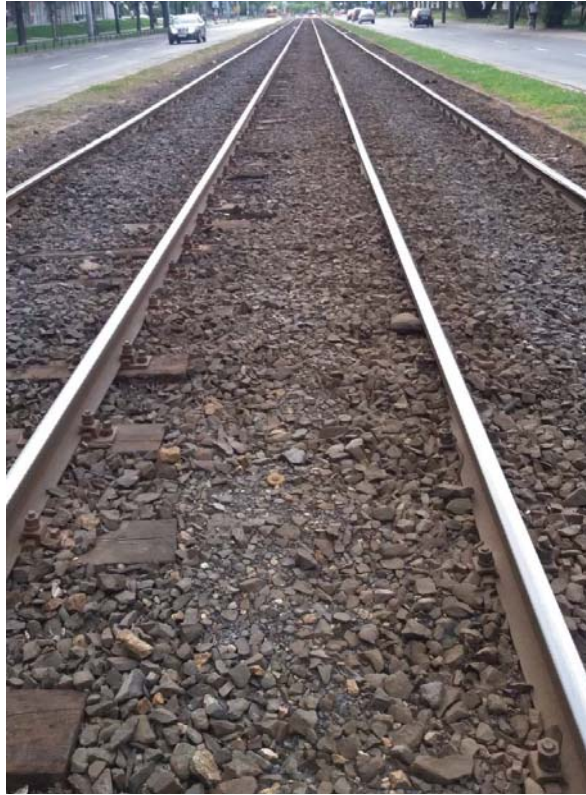
Rys. 1. Przykład klasycznego torowiska tramwajowego budowy otwartej, wydzielonego między jezdniami z wąskimi pasami zieleni na zewnątrz torów; szyny typu kolejowego posadowione są na podkładach drewnianych z przytwierdzeniem podkładkami K1 na wkręty do podkładu i łapkami do stopki szyn na śruby
