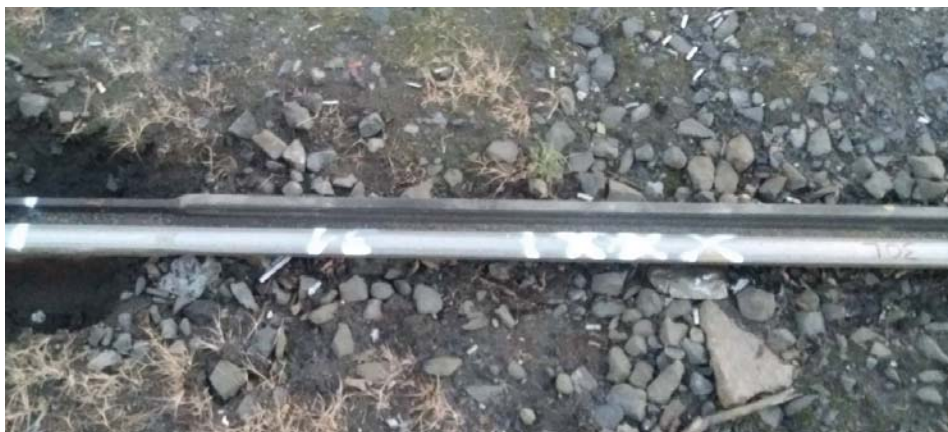
Rys. 18. Widok na przejście szyny rowkowej typu 180 S w rowkowi Ri60 na 31 odcinku szyn przewidywanych do dalszego badania; istotna różnica pomiędzy tymi szynami to grubość kierownicy wyraźnie widoczna na zdjęciu
