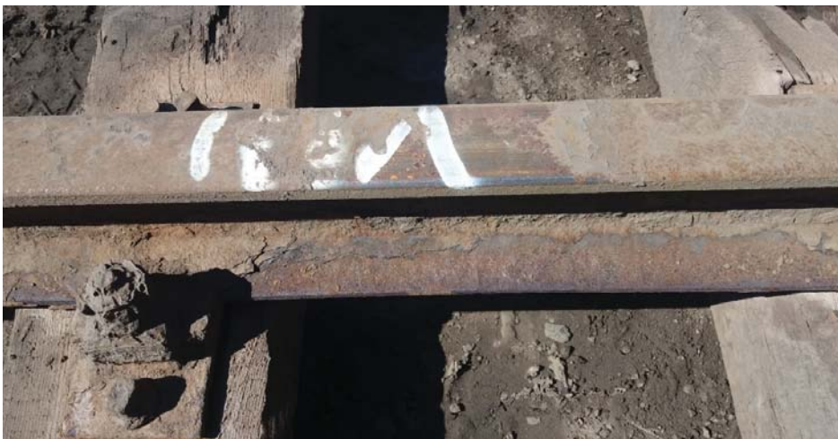
Rys. 13. Fragment szyny ze strefy katodowej wraz z mocowaniem do podkładu po procesie mechanicznego oczyszczenia z widocznymi śladami warstw nałożonych w procesie galwanicznego nanoszenia jonów elektrolitu glebowego i odsłoniętego żelaza (właściwego materiału) stopki szyny
