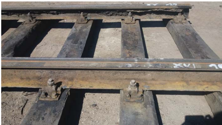
Rys. 10. Widok fragmentu rusztu torowego (prześła szynowego) z rysunku 9 już po mechanicznym oczyszczeniu metodą wstrząsową; na górnej szynie widoczne są jeszcze pozostałości materiału uszczelniającego pomiędzy płytą a główką szyny
