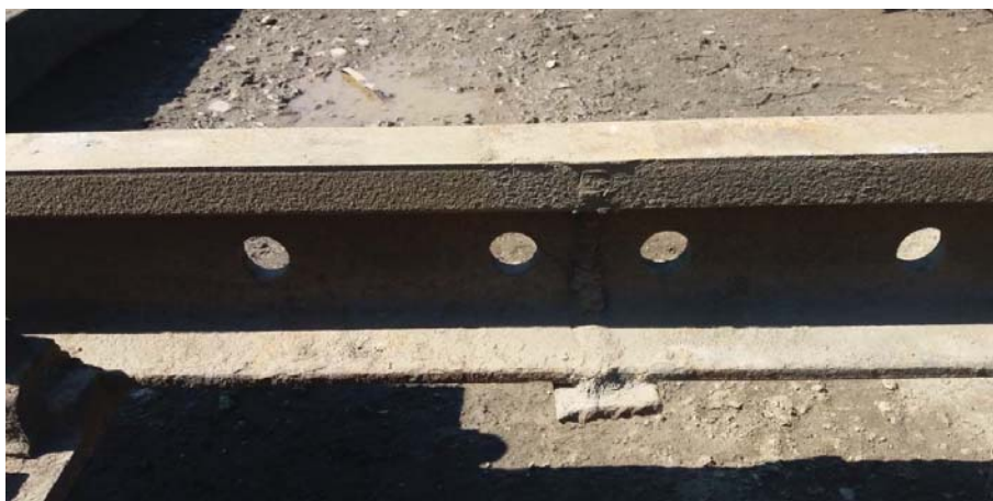
Rys. 17. Spoina spawania elektrycznego dwóch końców szyn kolejowych dostarczonych przez producenta, o czym świadczą okrągłe otwory technologiczne w szyjce szyny, po dwa na każdą stronę od spoiny
