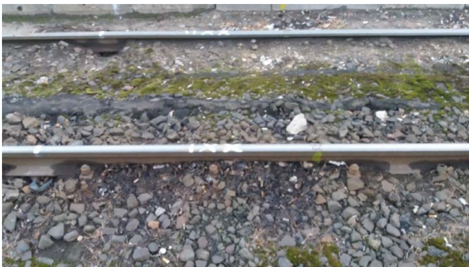
Rys. 2. Przykład klasycznego torowiska tramwajowego w strefie przystankowej; widoczne są między szynami wycieki smaru z przekładni starszych typów tramwajów, u góry krawężnik wysepki dla pasażerów; na szynach naniesione są znaki informacyjne – miejsca rozcięcia szyn do demontażu rusztu torowego (numeracja odcinków szyn i miejsce wyznaczenia profilu główek szyn w torze przed jego demontażem)
