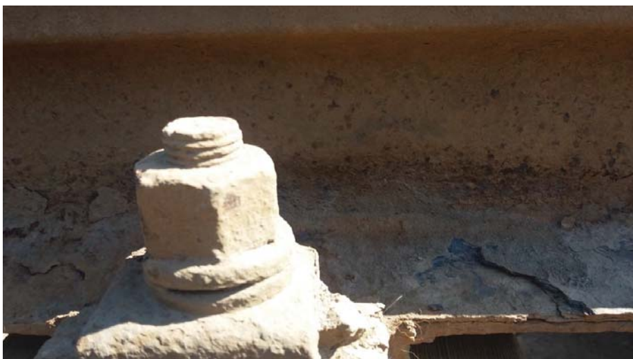
Rys. 24. Widok śruby z nakrętką mocujące stopkę szyny do podkładu, które pracowały w strefie katodowej; kolory rdzy wskazują, że poziom tłucznia nieznacznie przewyższał stopkę szyny, mechaniczne otrząsanie ujawniło pęknięcie wzdłuż materiału stopki szyny po prawej stronie od mocującej śruby
