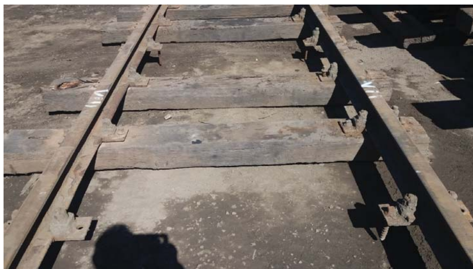
Rys. 12. Widok rusztów torowych z obu torów wyjętych ze strefy katodowej torowiska; stan po wykonaniu czyszczenia mechanicznego metodą wstrząsową
