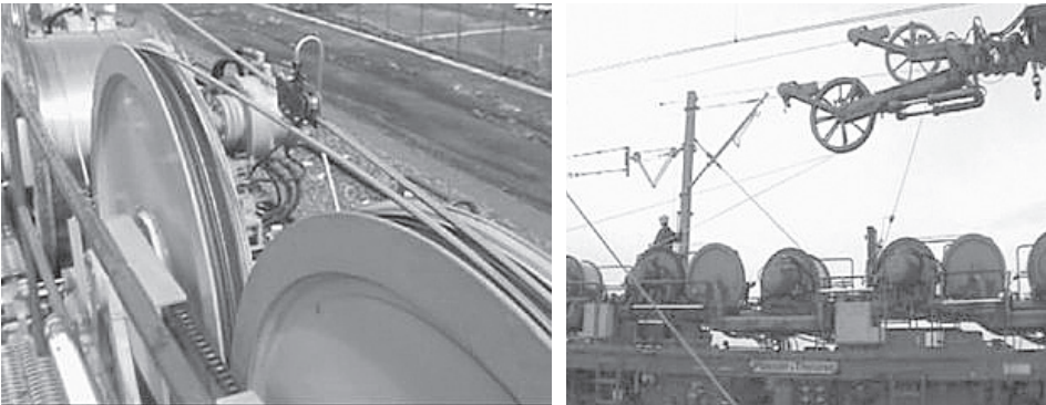
Fot. 6 i 7. Układ podajników i rolek zestawu PWST, prowadzących liny nośne i przewody jezdne
