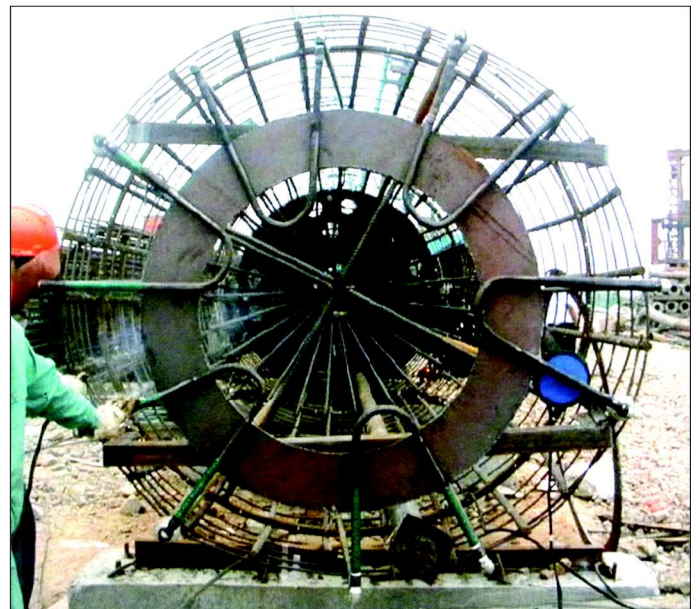
Rys. 10. System rozprawiania iniektu „TAM” użyty pod stopami pali średnicy 2,5 m w moście Sutong, zawierający 2 x 6 odcinków rur rozprawiających, Chiny [1]
