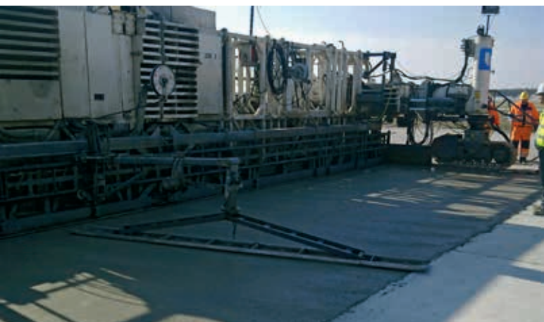
Zespół maszyn do układania nawierzchni betonowej SP1500, fot. PORR Polska Infrastructure SA
