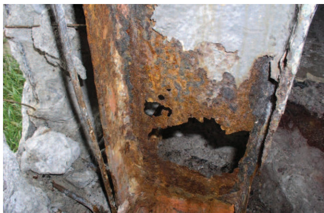
Rys. 1. Przykłady całkowitej degradacji stalowych rygli i słupów. Wady połączeń spawanych
