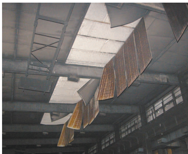
Rys. 4. Widok uszkodzonych elementów hali. Fragmenty odspojonych blach dolnych
