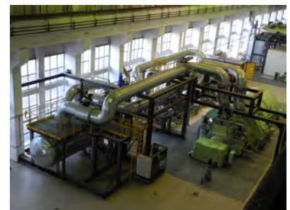
Fot. 2. Turbozespół TG5 z rurociągami pary z turbiny do wymiennika ciepła
