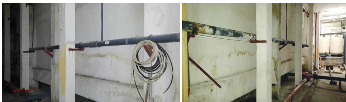
Rys. 2. Widok układu konstrukcyjnego ścian basenu przed pracami naprawczymi [8]
