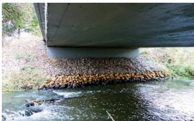
Ryc. 5. Negatywny przykład umocnienia wykonanego w postaci gabionów bez zastosowania warstwy ochronnej, utrudniającego migrację zwierząt, fot. A. Wysokowski
