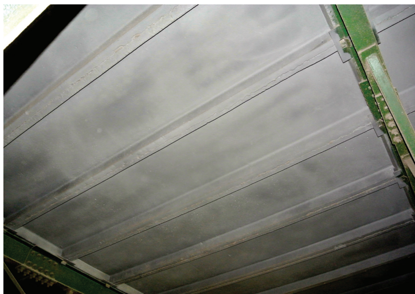
Fot. 2. Widok fragmentu dachu maszynowni i stanu technicznego płyt korytkowych
