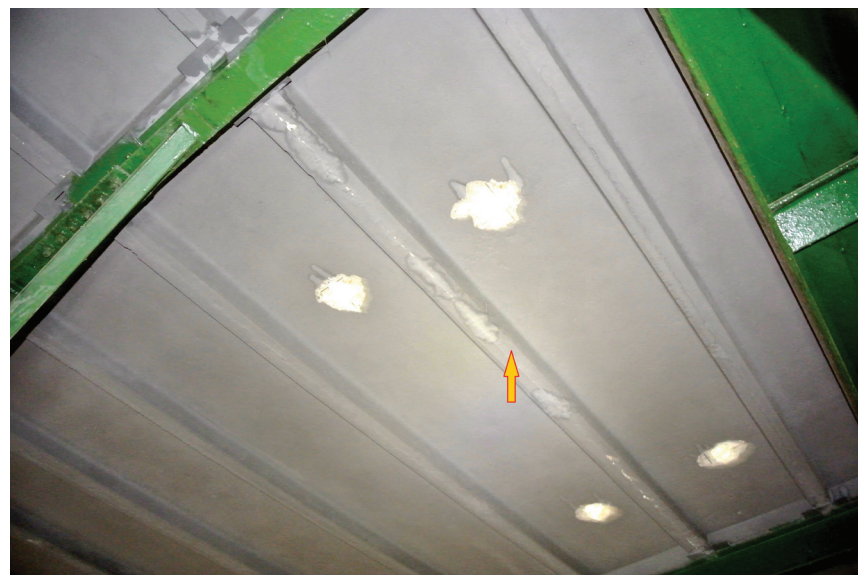
Fot. 3. Widok badanych żeber po odciążeniu, zlokalizowanych pomiędzy odwiertami
