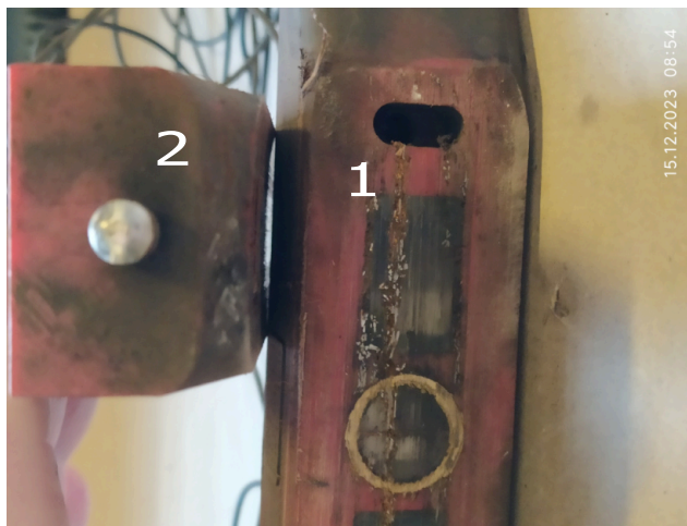
Rys. 6. Zużycie bloków głowic: 1) wbite w głowicę opilki metalu z łuszczących się szyn; 2) zmiana kształtu powierzchni bloku poprzez wytarcie na nieregularny łuk.
