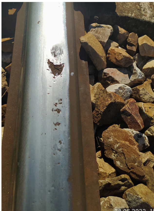
Rys. 7. Głębokie uszkodzenia powierzchni toczonej szyny mogące mieć wpływ na film cieczy sprzęgającej
