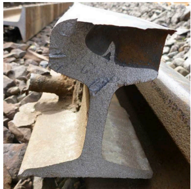
Rys. 1. Pęknięcie poprzeczne szyny z wżerem korozyjnym Fig. 1. Transverse crack with corrosion pitting
