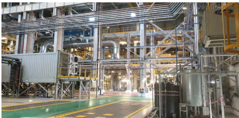
Maszynownia 0,0 m – widok w stronę turbiny parowej
