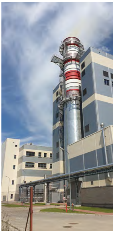
Kotłownia oraz komin
