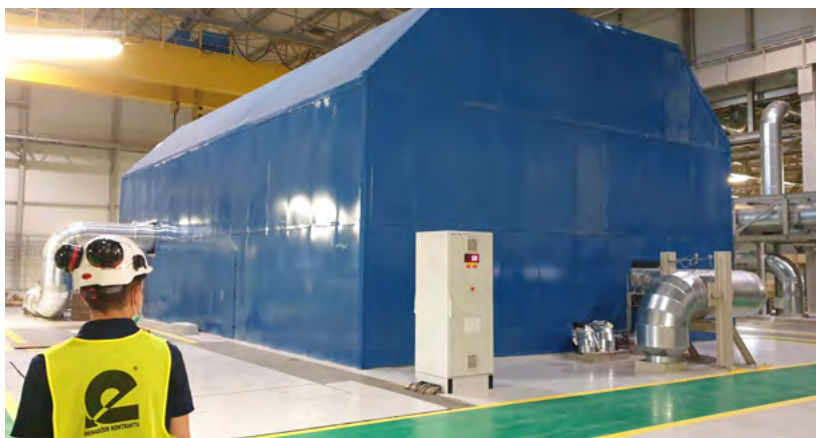
Turbina parowa w obudowie akustycznej w trakcie prób
