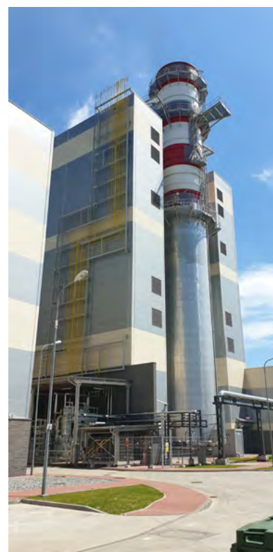
Kotłownia z kominem oraz stacja podgrzewu gazu
