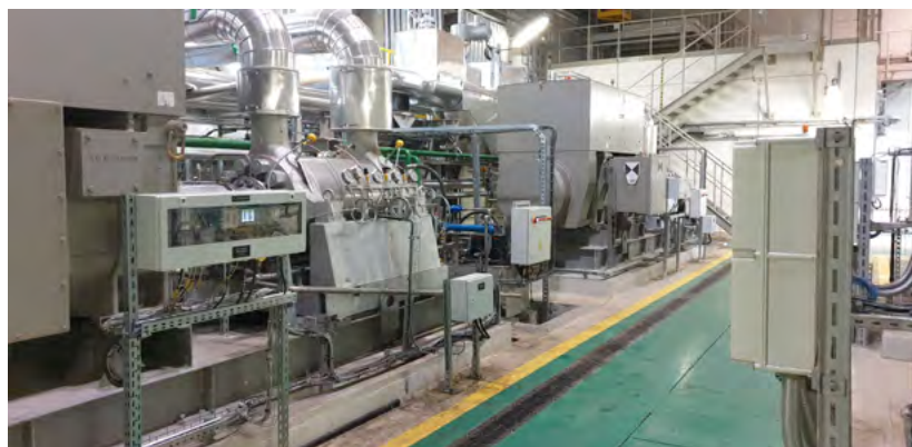
Pompa wody zasilającej
