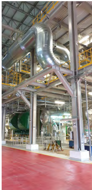
Część turbinowa – poziom 0,0 m
