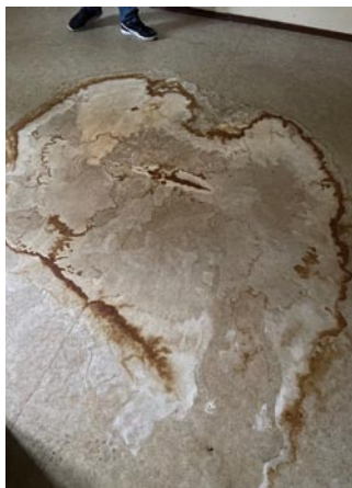
Rys. 6. Posadzka na drugiej kondygnacji, widoczne ślady zalania
