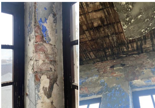
Rys. 8. Uszkodzenia tynków i stropu w wieży widokowej
