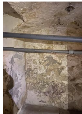
Rys. 9. Ściany piwnicy, widoczne odspojenia tynków i zasolenie murów
