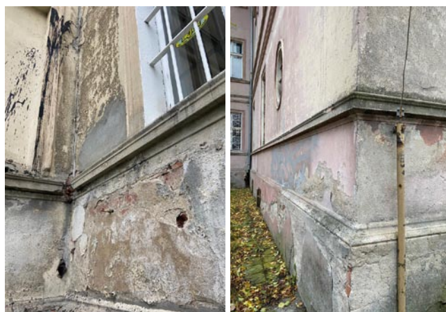
Rys. 5. Uszkodzenia elewacji spowodowane zawilgoceniem
