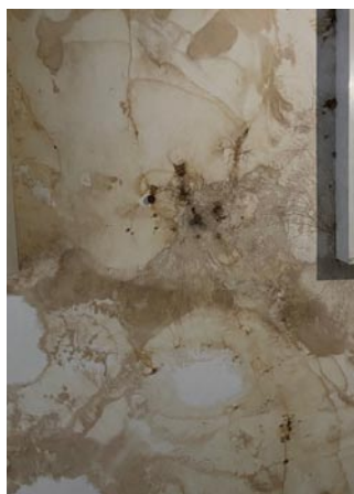
Rys. 7. Sufity na drugiej kondygnacji, widoczne zawilgocenie; strop drewniany, ze ślepym pułapem
