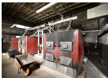
Rys. 4. Kotłownia (fotografia własna) Fig. 4. Coal boilers (own photography)
