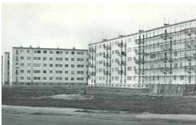
Rys. 3. Czteropiętrowe budynki przy ul. Bułgarskiej – od ul. Marcelesińskiej w kierunku ul. Świerczewskiego (dzisiejszej ul. Bukowskiej), system PBU, (fot. S. Leszczyński, 1969 r. ze zbiorów Biura MKZ w Poznaniu)
