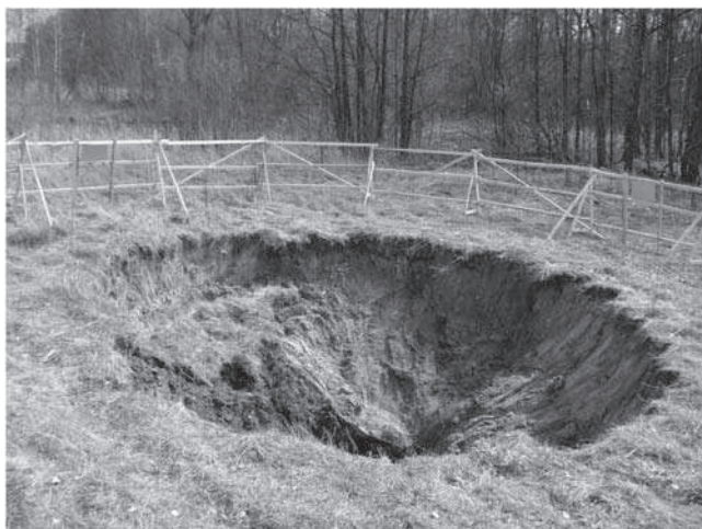
Rys. 9. Zapadlisko w miejscu szybu wentylacyjnego Pohlenez VII, okolice wsi Słone, rok 2006, fot. M. Bialek
