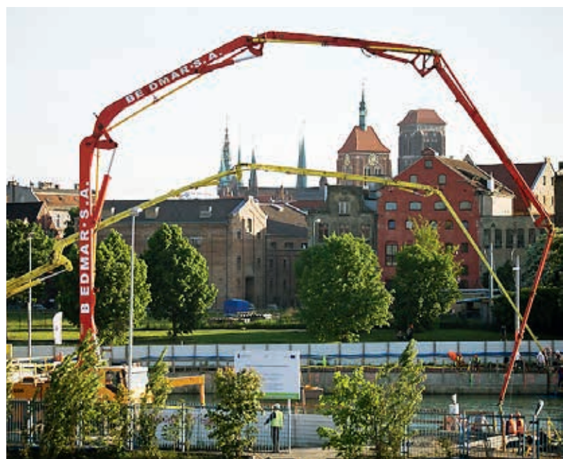
Prace przy wykonaniu korka betonowego w wykopie, fot. R. Jocher, Muzeum II Wojny Światowej w Gdańsku
