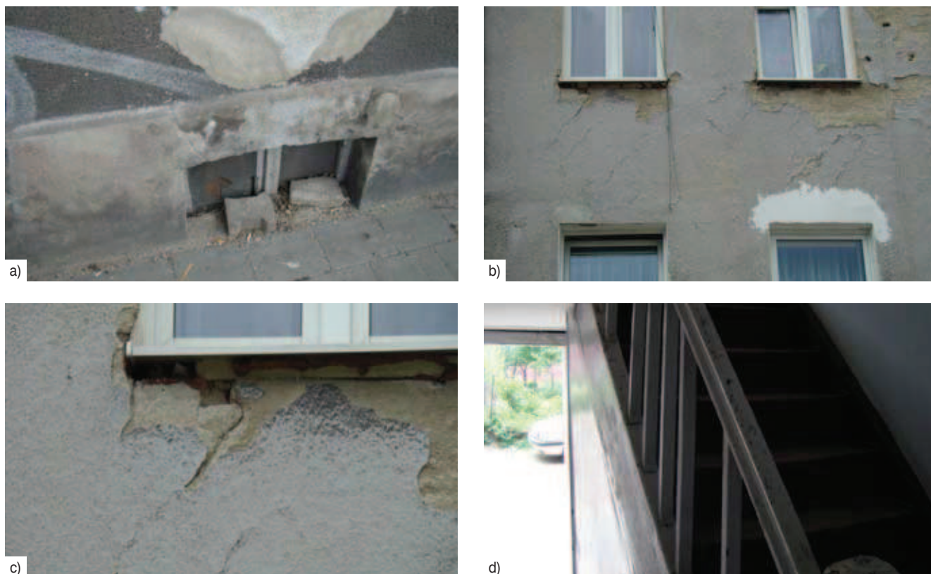
Rys. 5. Budynek Mieszkalny Cywili: mury zewnętrzne: zawilgocenia w strefie przyziemia (a) oraz zarysowania stref podparapetowych w widoku ogólnym (b) i zbliżeniu (c), dekapitalizacja klatki schodowej (d)
