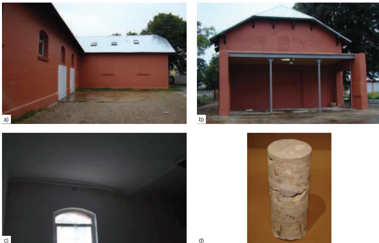
Rys. 6. Budynek Stajni: a), b) widok ogólny, c) sklepienie betonowe w poziomie stropu nad parterem, d) próbka betonu (odwiert rdzeniowy) pobranego ze sklepienia
