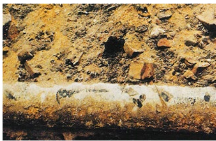
Ryc. 8. Rura stalowa z widocznymi wokół niej dużymi kamieniami [1]
