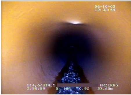
Ryc. 14. Wbijanie się kamienia w ściankę rury PVC, fot. A. Kuliczkowski
