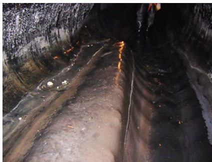
Ryc. 11. Utrata stateczności powłoki rury polietylenowej PE-HD (zdjęcie przekazane autorowi)
