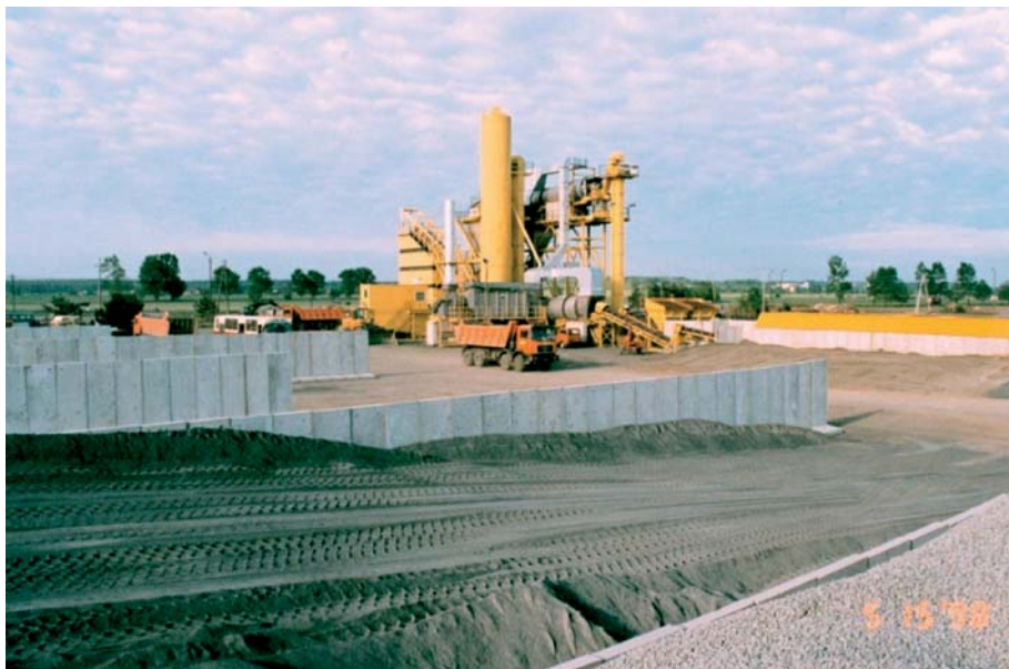
Fot. 4. Dwususzarkowa wytwórnia mieszank mineralno-asfaltowych AMMAN Quick 180/240 zainstalowana na bazie firmy Dromex Construction Sp. z o.o. w Magnuszowicach (fot. K. Jabłoński)
