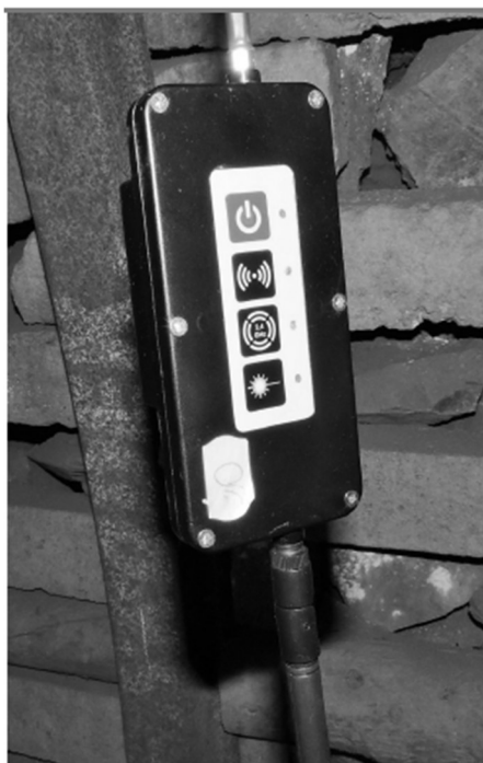
Rys. 3.4 Widok repeatera REP 1.0. zawieszony w wyrobisku
