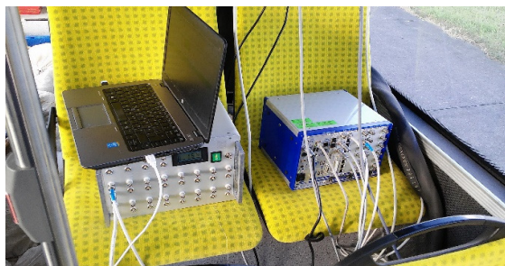
Rys. 4. Cyfrowy rejestrator do pomiaru parametrów elektrycznych
