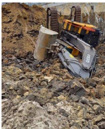
Rys. 6. Widok przewróconej w wykopie koparki
