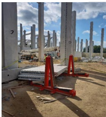
Rys. 8. Wywrócenie się stojaka z płytami prefabrykowanymi
