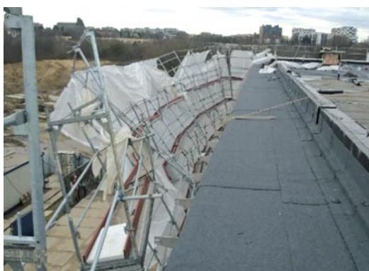
Rys. 7. Widok oderwanego od ściany rusztowania elewacyjnego
