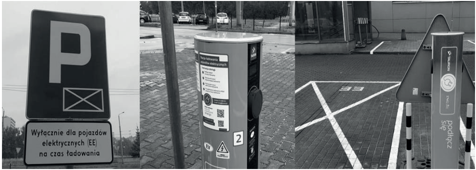
Rys. 1. Stacja ładowania pojazdów elektrycznych w Tychach
