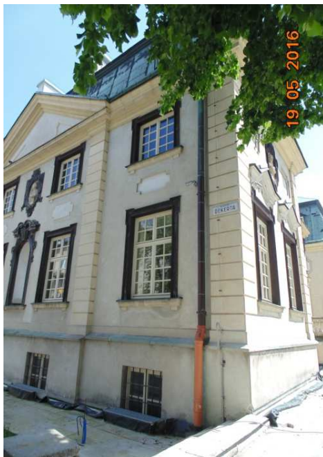
Rys. 3. Narożnik północno-wschodni budynku - zacieki, uszkodzenia Fig. 3. North-eastern corner of the building - stain, defects
