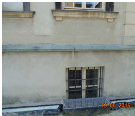
Rys. 4. Jak obok, zbliżenie uszkodzeń Fig. 4. As the next, enlargement of defects
