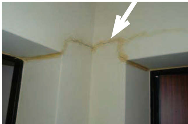
Rys. 8. Zarysowanie poziome ściany korytarza przy drzwiach wejściowych do mieszkania nr 2 (z lewej) i mieszkania nr 3 (z prawej)
