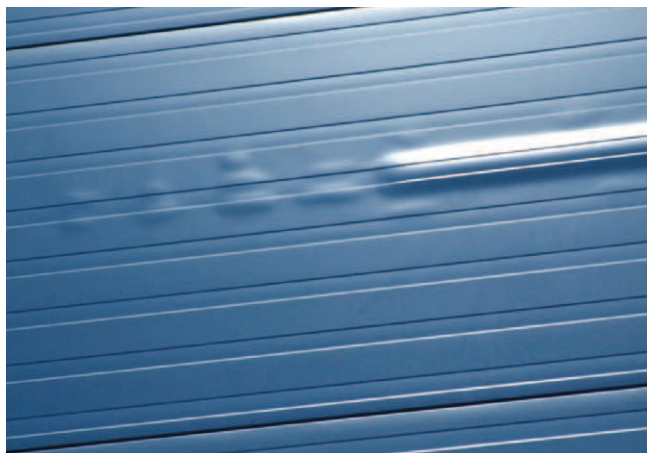
Rys. 2. Uszkodzenia płyty obudowy
