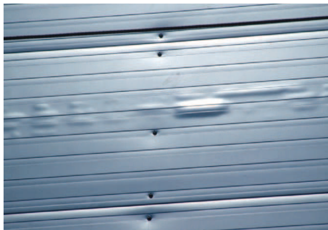
Rys. 3. Uszkodzenia płyty obudowy
