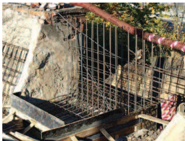
Fot. 8. Wkładki zbrojeniowe wraz z wstępnym szalowaniem – faza montażu żelbetowego przyczółku mostu
