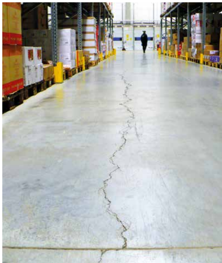
Fot. 1. Rysy (pęknięcia) płyty betonowej posadzki w magazynie
