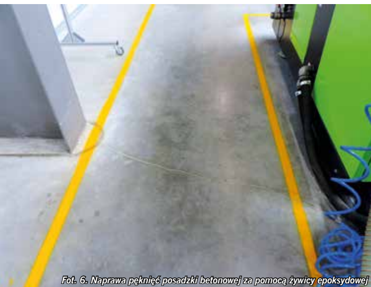
Fot. 5. Rysy (pęknięcia) posadzki w technologii DST wypełnione żywicą epoksydową
