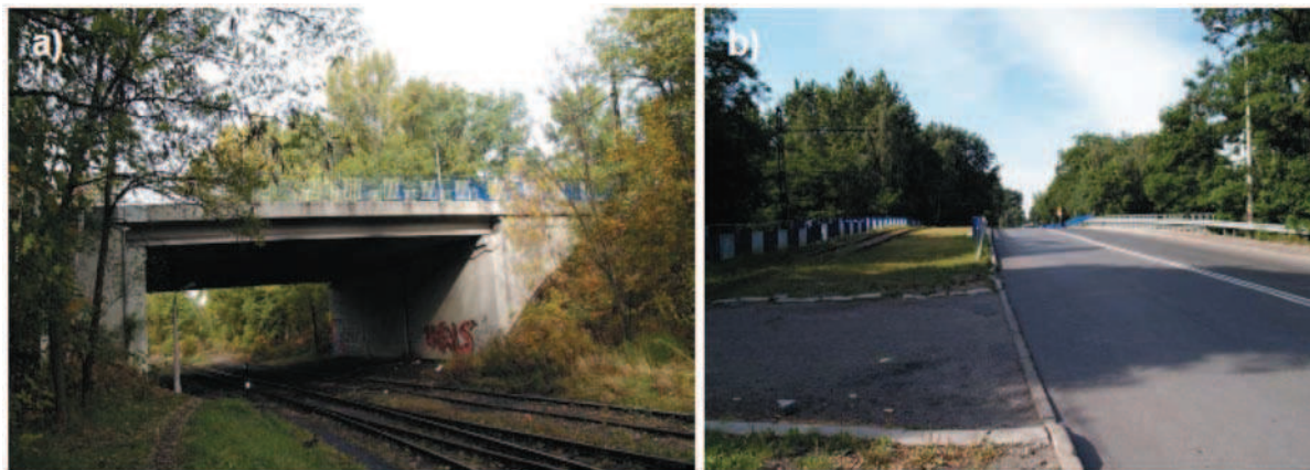
Rys. 1. Wiadukty – tramwajowy i drogowy a) widok od strony południowo-zachodniej, b) widok od strony północno-wschodniej
