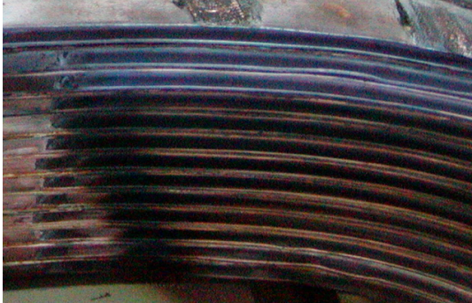
Rys. 1. Początkowa faza uszkodzeń czoł uzwojenia wzbudzenia turbogeneratora
