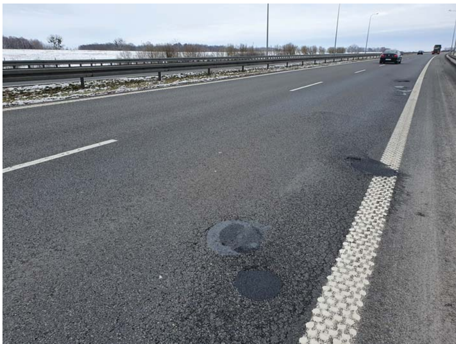
Fot. 1. Widok ubytków w nawierzchni drogi ekspresowej wypełnionych mieszanką mineralno-asfaltową na zimno
