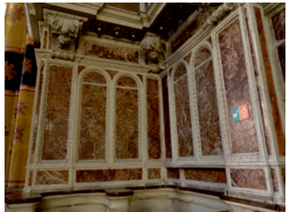
Fot. 11. Elewacja wewnętrzna wykonana z różanki na ścianach w Kościele Mariackim w Krakowie Fot. 11. The external facade made of "rózanka" calcite on the walls of St. Mary's church in Krakow
