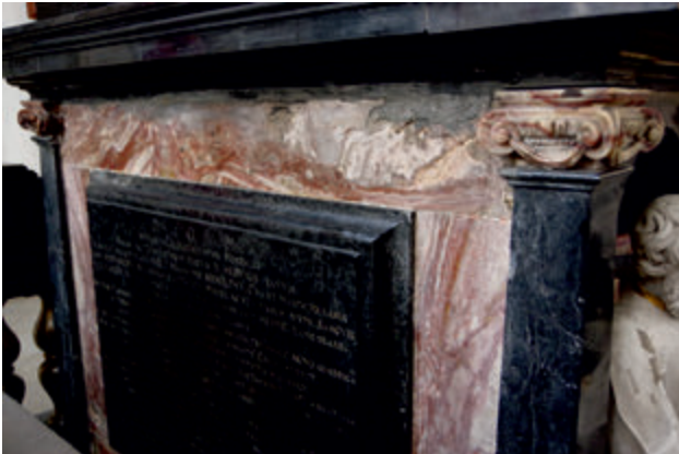
Fot. 13. Brakujące elementy z różanki na grobowcu św. Jadwigi Śląskiej w klasztorze w Trzebnicy
